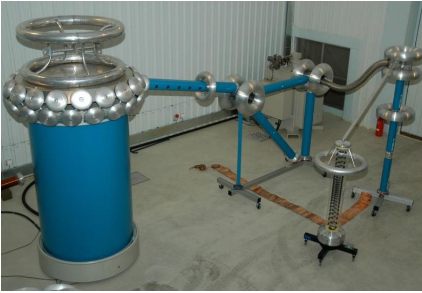
400 kV AC Yüksek Gerilim Sistemi
